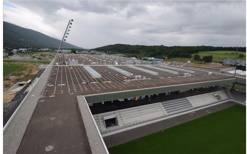
Bau der Anlage Ost-West 2015 – 3,5 Mio sFr.
